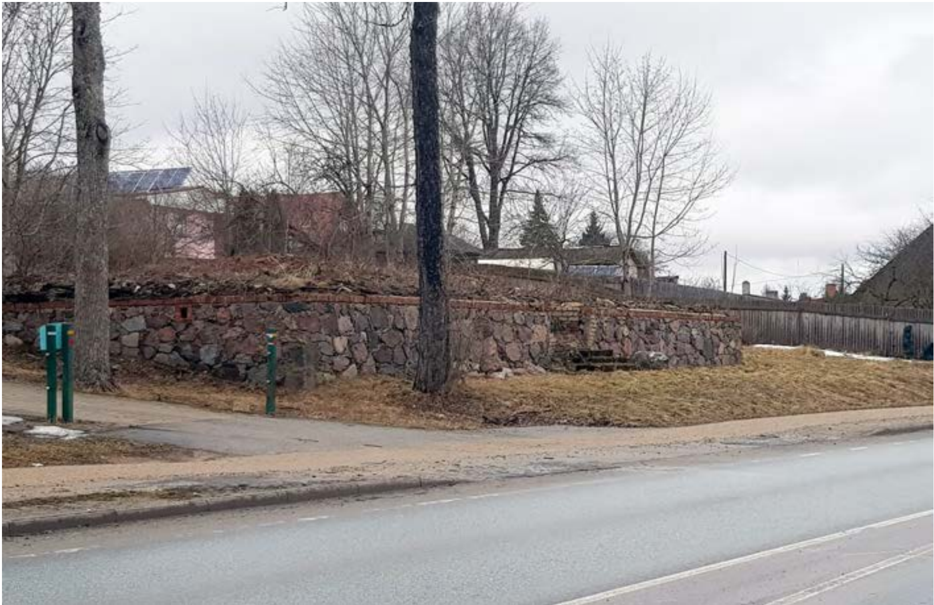
Foto 32. Säreveere vallamaja (ehit. 1893) vundament (Pärnu tn 52)
